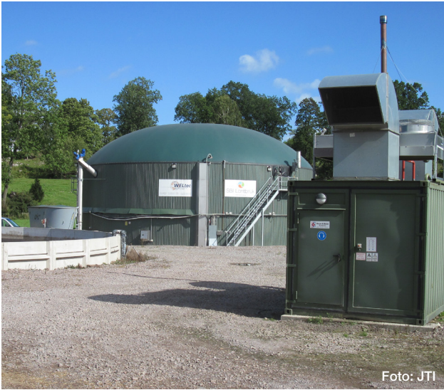
Figur 10. Biogasanläggning för rötning av stallgödsel på mjölkfogård med lager för rötad gödsel.
